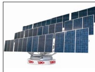
Planta solar fotovoltaica
